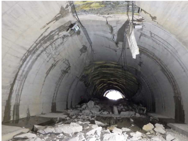
被災状況 2024.2.6撮影
