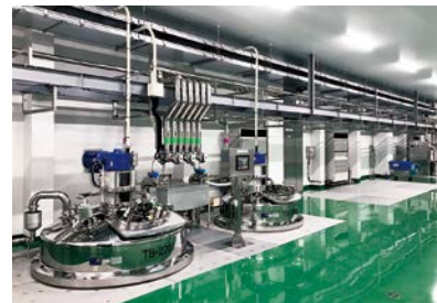
ヤマサ醤油滋賀竜王工場 製造タンクおよび自動原料供給設備
