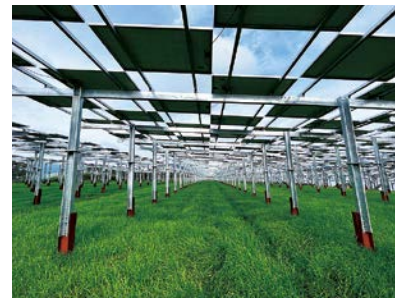
熊本小国営農型太陽光発電所
