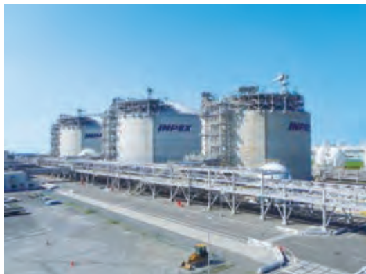
直江津LNG基地
