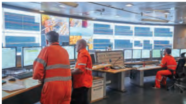
CPF内のコントロールセンター
