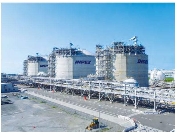
Naoetsu LNG Terminal
