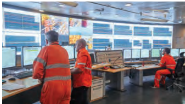
CPF内のコントロールセンター
