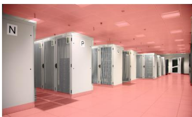
ビルの屋上・床面警戒 データセンター、エネルギー関連施設
